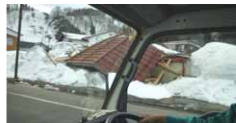
雪の残る道路沿いの壊れた家屋
